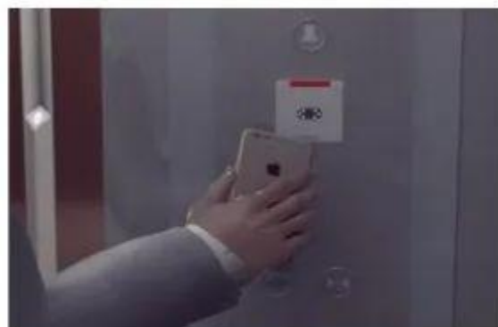
二维码电梯控制 (仅访问楼层)
